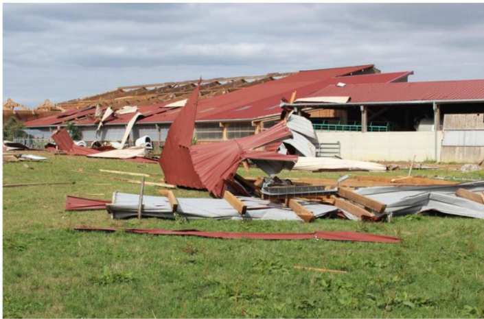
La toiture d'un bâtiment agricole a été soufflée. Photo Jean-Pierre Zonca
