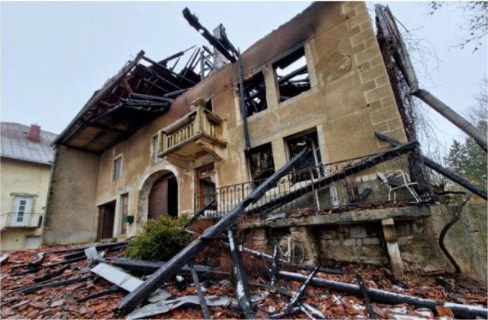
Le logement de Christian Bouday a fini totalement ravagé par l'incendie qui l'a tué, ce lundi. Photo Victor Massias
